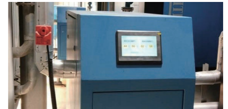
空压机余热回收改造
